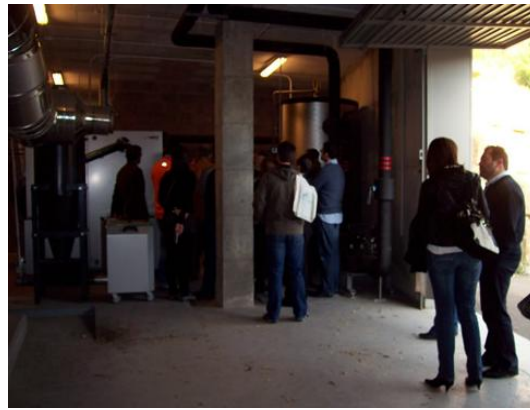
Figura 4. Explicación del funcionamiento de la caldera de viruta de biomasa que proporciona calor al CTFC
